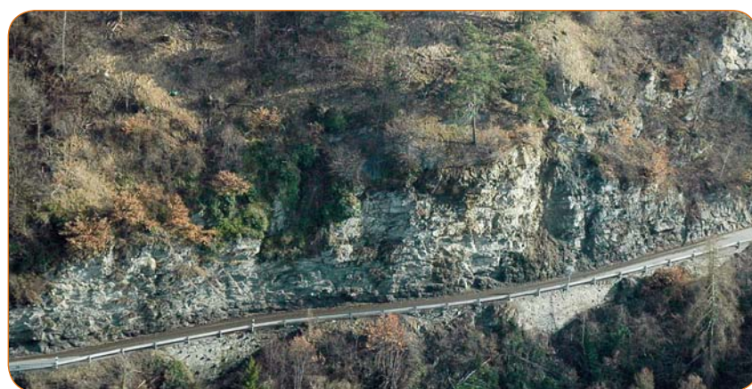
Des pierres instables menacent de tomber sur la route cantonale. Les travaux de sécurisation sont donc une réelle nécessité. © Droits réservés
