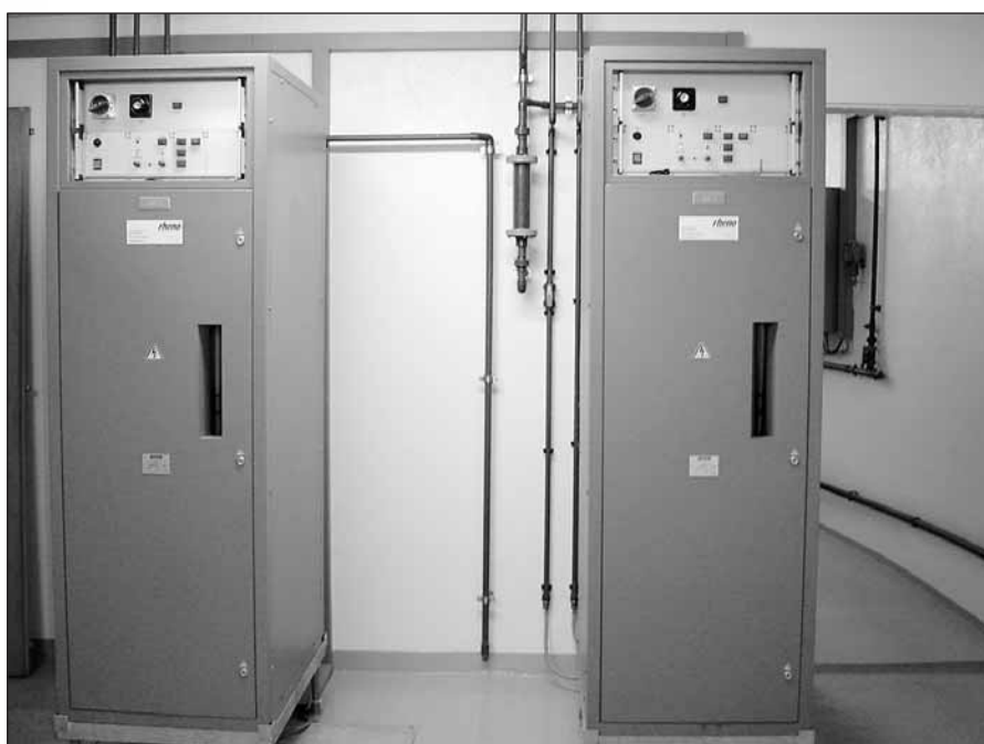
Ozoneurs de la station de traitement de Pramounet (production d'ozone).
